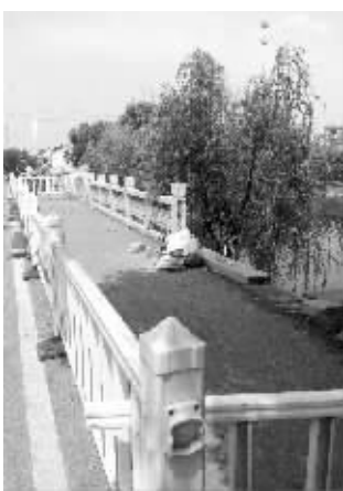
现场约1米的桥栏杆被撞飞
