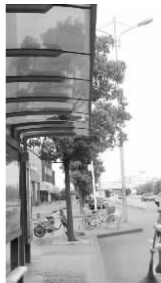
站台顶棚玻璃破裂 报料人供图
