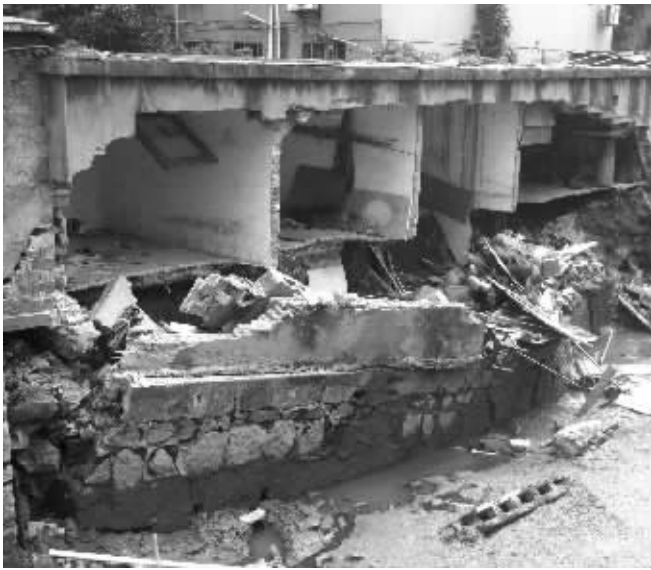
四个车库塌塌,木板等杂物散落在河道中
