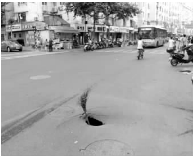
路面塌了一个大洞 报料人供图
