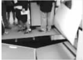
地板塌陷制造混乱
