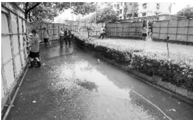
路面出现塌陷, 现场已经围挡 现代快报记者 施向辉 摄
