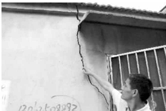
▶墙上的裂缝能伸进手指 见记者 马晶晶 摄
