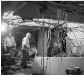
工作人员在检查受损情况 新华社记者 覃海石 摄
