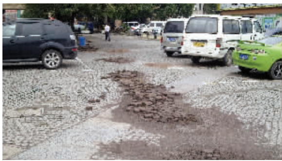
小区商业街的路面坑坑洼洼
