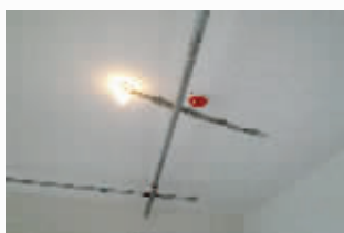
消防喷淋设备妨碍装修
