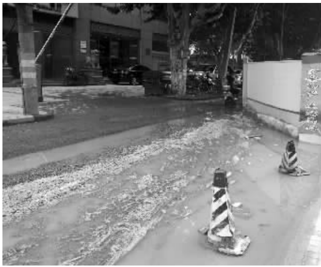
施工现场路面已泥泞不堪
