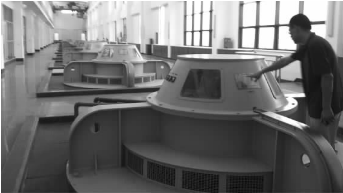
目前我国单站流量最大的泵站——临洪东站,拥有12台机组 现代快报记者 王晓宇 摄
