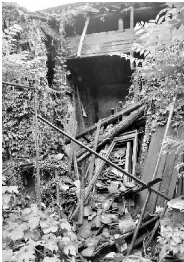
汤家巷杨宅最后一进的门楣坍塌,木质屋梁、花窗、瓦片堆满地
