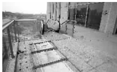
闲置使紫金山东站的部分设施脏旧了
