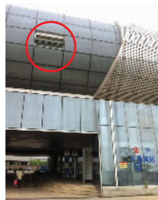
画圈处为玻璃幕墙爆裂位置 现代快报记者 聂聪 摄
