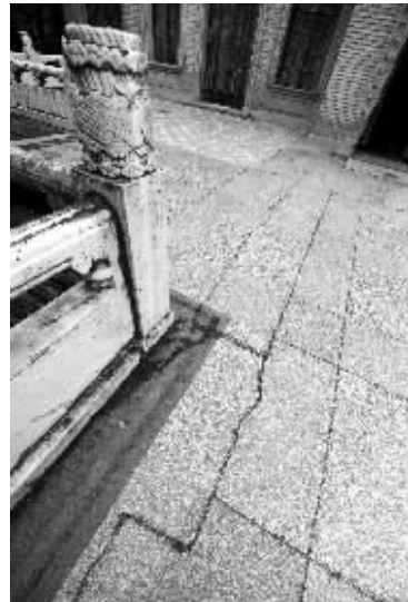
地面多处开裂 现代快报记者 赵杰 摄
