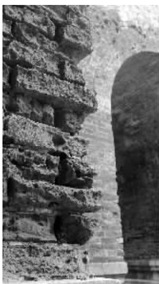
雨水侵蚀墙体受损
