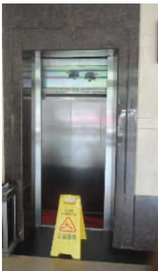
出事的电梯门口已经放上“正在维修”的牌子
