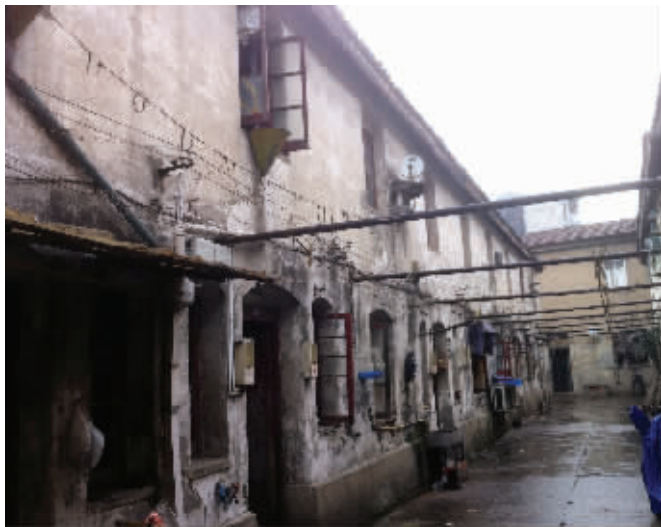
丽新工房不仅陈旧而且地势很低,一到雨天就积水
