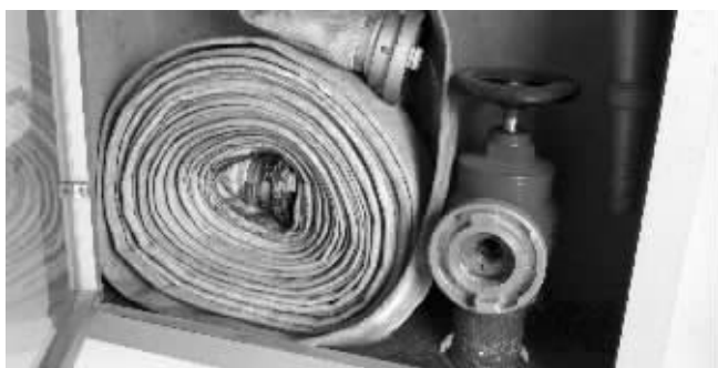
鸿仁名居内的一个消防栓放不出水
