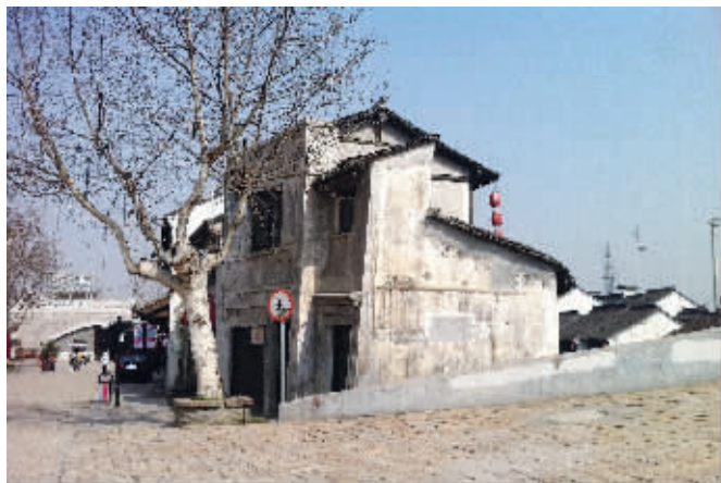
这栋楼的一面向东倾斜了约10°,有关单位说安全没问题 匡笠 摄
