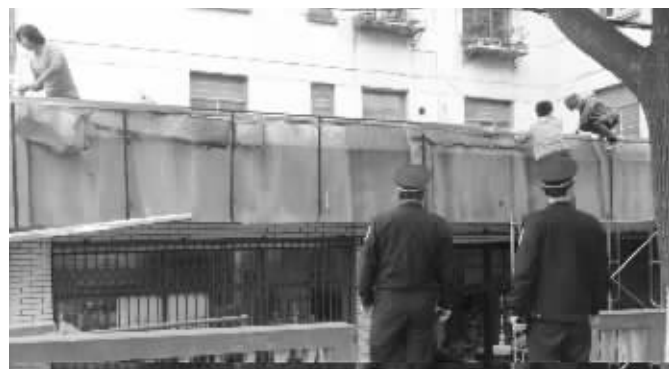
北塘区五河新村内的五河桥桥堍附近有不少违规户外广告导致桥面狭窄,每天都很拥挤,昨日,北塘城管对此进行了拆除。据悉,共清除20块户外广告,总面积达200㎡。 查彦 胡姗姣
