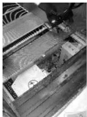
“吞人”的电梯设备箱有1米多深
