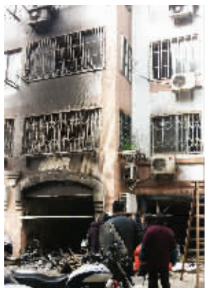
两间车库被烧毁,楼上墙壁被熏得一片漆黑
