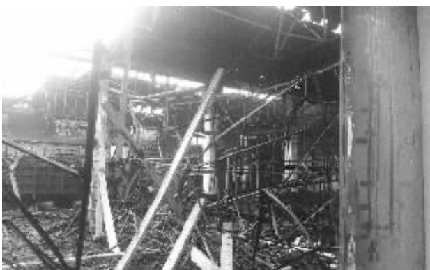
被烧毁的泡沫塑料车间
