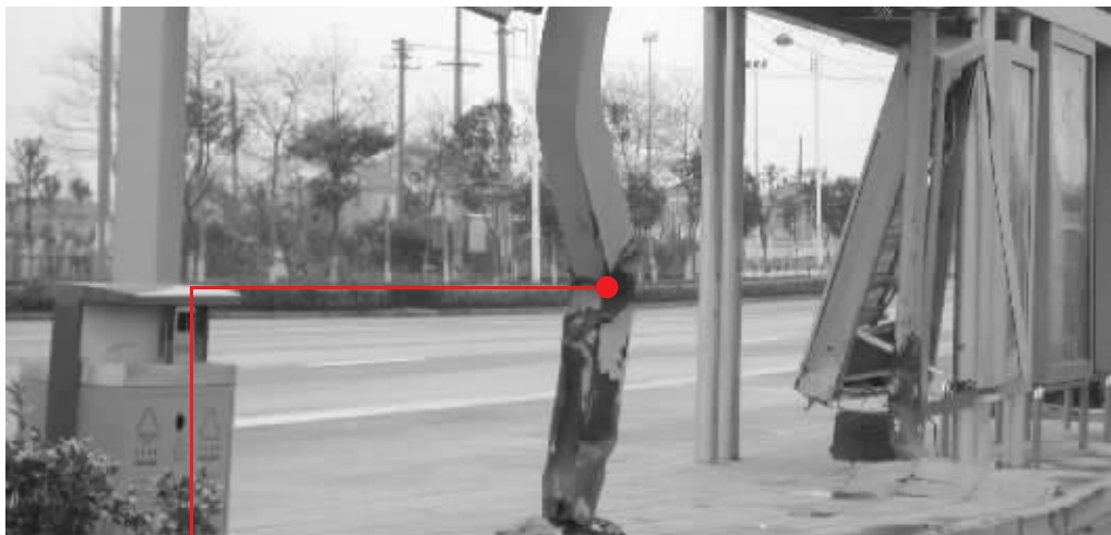
被撞坏的站台钢管
