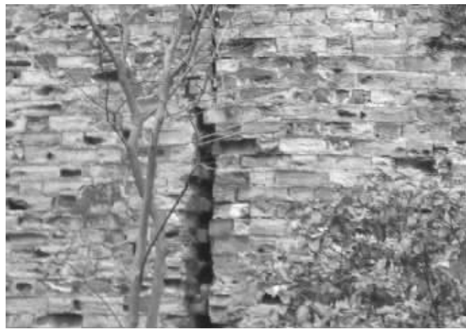
城墙上的裂缝能伸进胳膊
