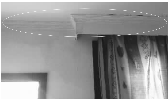
水秀新村改造之后,一些居民家的房顶出现渗水现象 匡笠 摄
