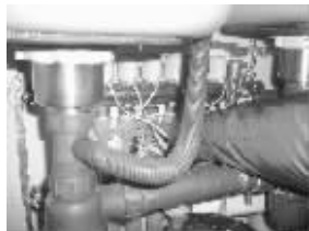
王先生说,就是这个地方漏水,殃及邻居
