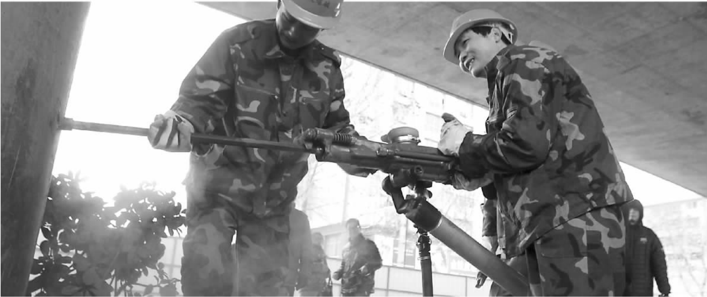
昨天,水西门高架桥封闭施工,工人们开始在桥墩上钻孔 快报记者 顾炜 摄
