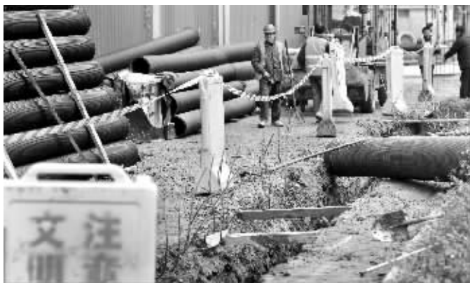
塌方现场 快报记者 施向辉 摄
