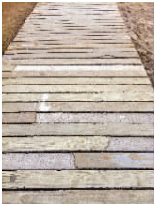
路面破损严重
