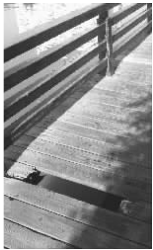
这里的木板已经脱落,路过时要小心
