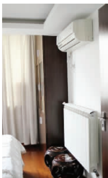
舒适家居系统安装实景图
