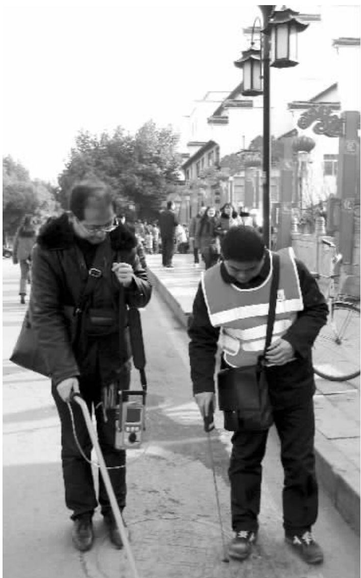
快报记者鲍铭东(左)和供气单位的工作人员一起巡查漏气点 倪学伟 摄
