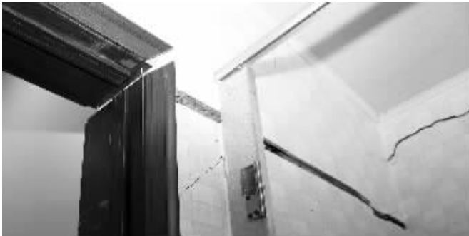
楼体沉降导致饭店内墙体严重开裂 实习生 马晶晶 摄
