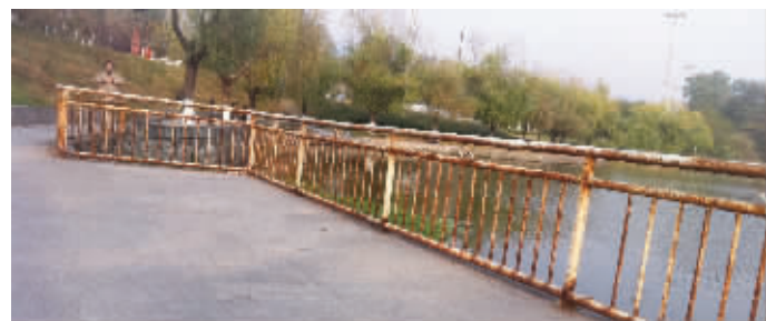
铁栏杆锈迹斑斑
