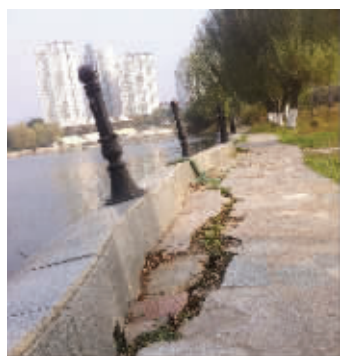
铁链没了,路面塌陷
