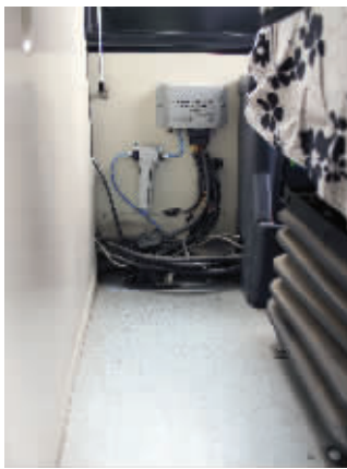
安装在驾驶室里的电子控制单元
