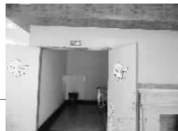
▶地点:某国际家居城 ▶隐患:标识牌使用灯箱材料
