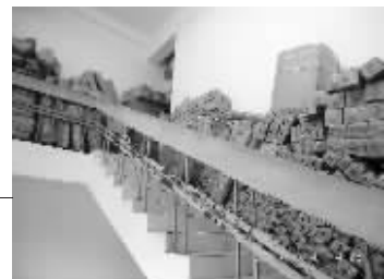
▶地点:某批发市场 ▶隐患:货物堵塞了楼梯
