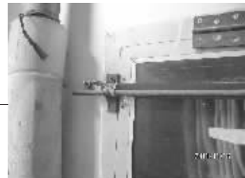
▶地点:某大市场 ▶隐患:安全门被焊死了
