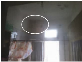
杨女士家卫生间墙面漏雨留下的水渍
