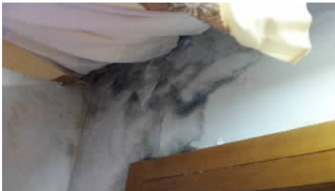
因为长期被水浸泡, 天花板与墙相连的地方出现了一大片霉斑
