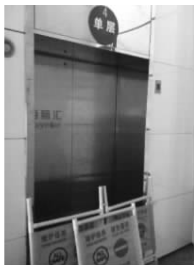
4号电梯因安全隐患还在维修 陆媛 摄
