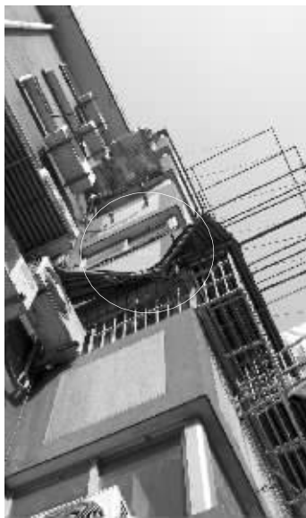
田师傅连续砸中4楼的空调架和3楼的雨篷,最后砸到楼前的草地上
