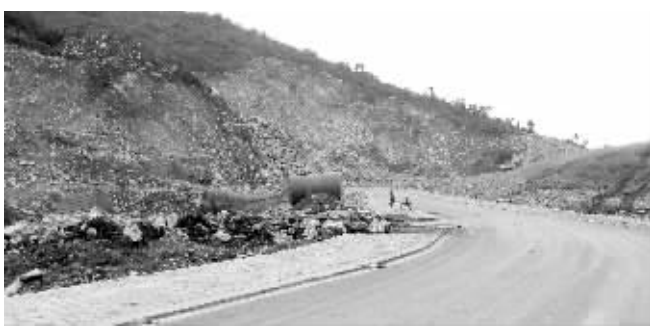
施工现场山体多处裸露 快报记者 孙玉春 摄
