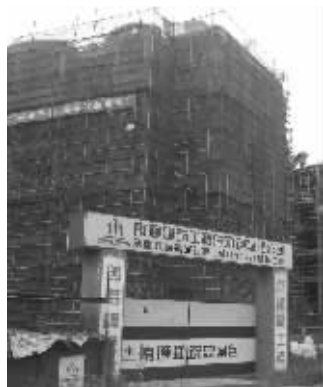
工地已被勒令停工
