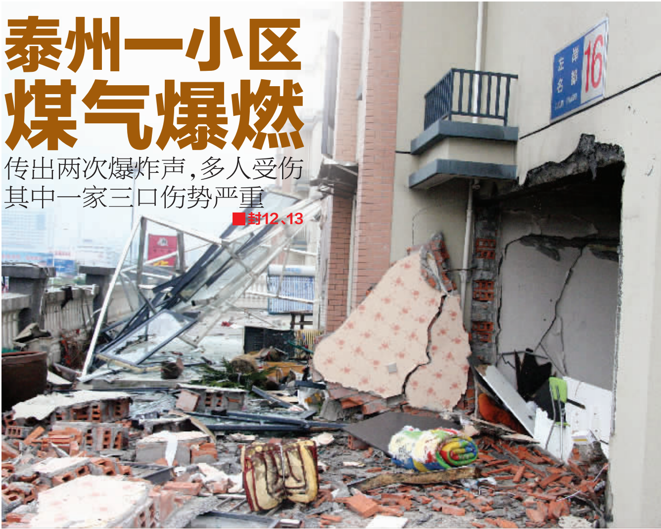
小区一户人家被炸掉了一面墙 通讯员 杨海 摄
