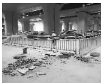
出租车停靠区入口,地砖破损
