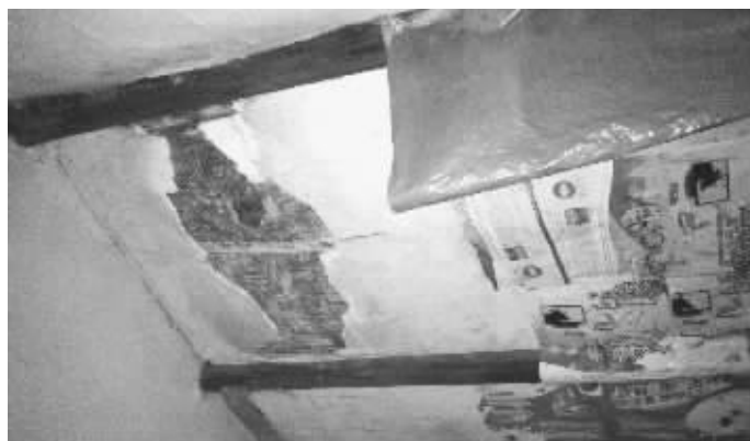
住户在屋顶糊上纸和塑料膜防漏 快报记者 姜毅弘 摄
