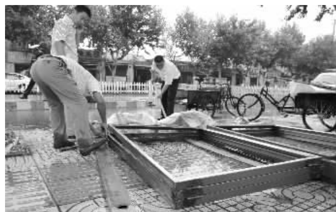
图为工作人员在清理倒塌的公交候车亭
