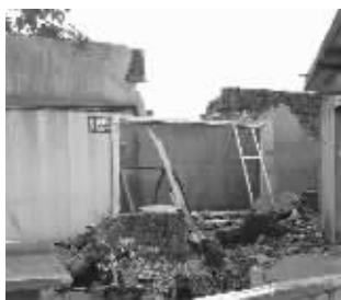
被风刮倒的树把围墙撞塌一块
